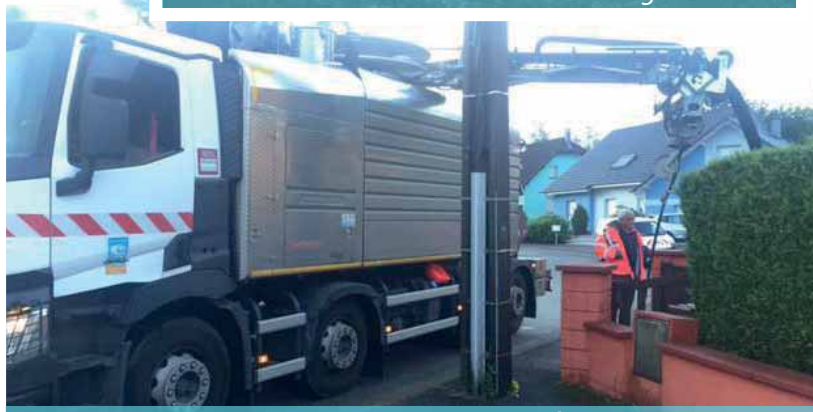
Évacuation des eaux
