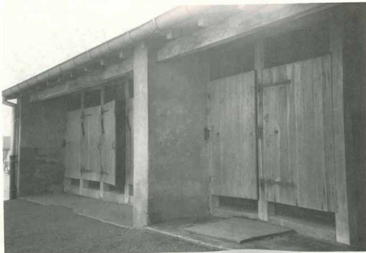
Les W.C. de l'Ecole du Centre : trop vétustes. Ils vont être démolis et sont d'ores et déjà remplacés par des nouveaux locaux intégrés à l'Ecole.
